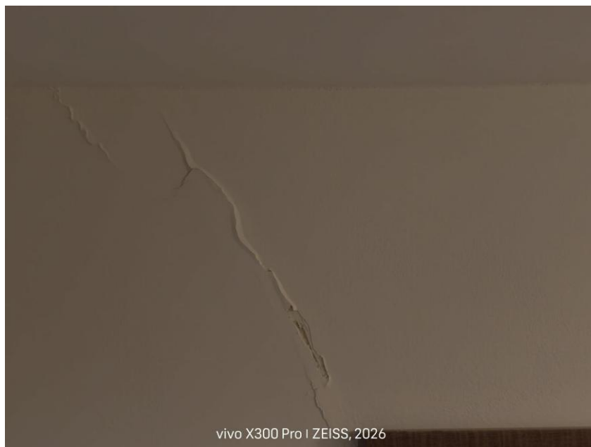
Foto 3 - Průběh trhliny v horní části příčky s napojením na strop; patrné je i odbočení do vodorovné polohy pod stropem.
